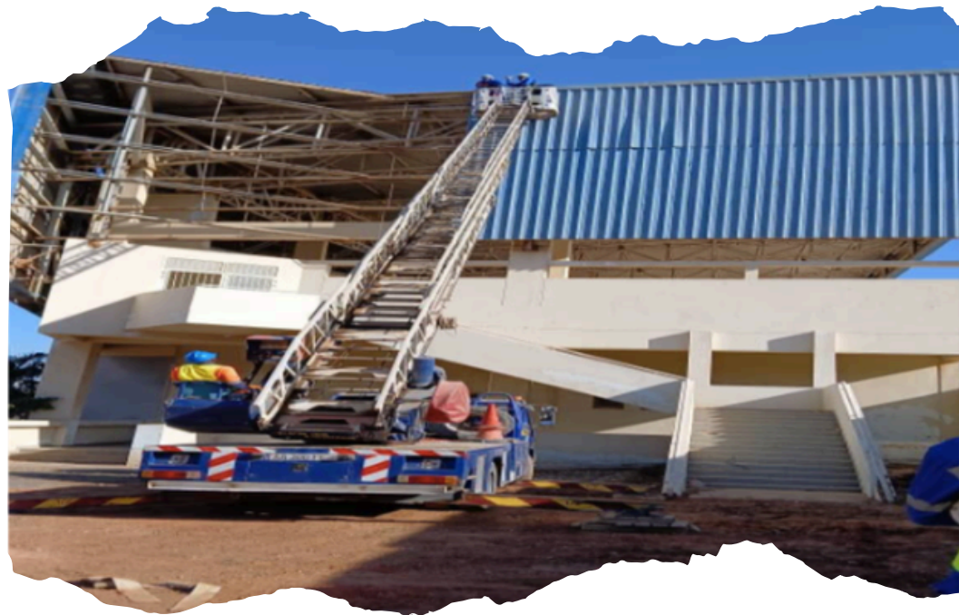
Travaux de réfection de la charpente de la piscine olympique de Dakar (travaux en cours) Client :Etat du Sénégal via SOGEA- SATOM
