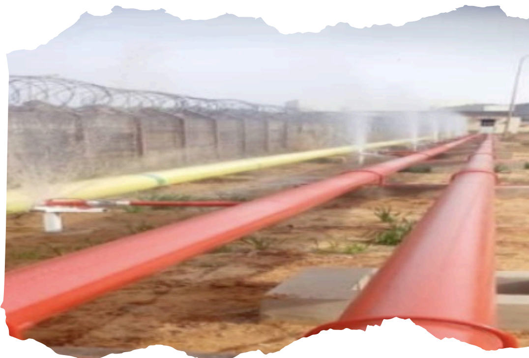
Réalisation d'un pipe 780m (queue de paon) Client: Société Africaine de Raffinage (SAR)
