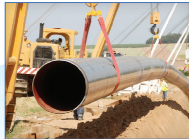
Conduites (pipeline et sealine)
